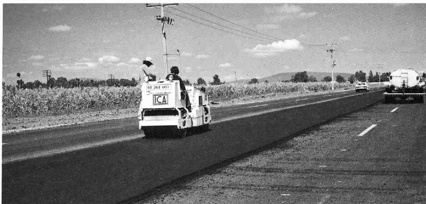
Arriba, labores de compactación en la ampliación de la carretera Irapuato-Salamanca; abajo, maquinaria de ICA en la colocación de sello.
