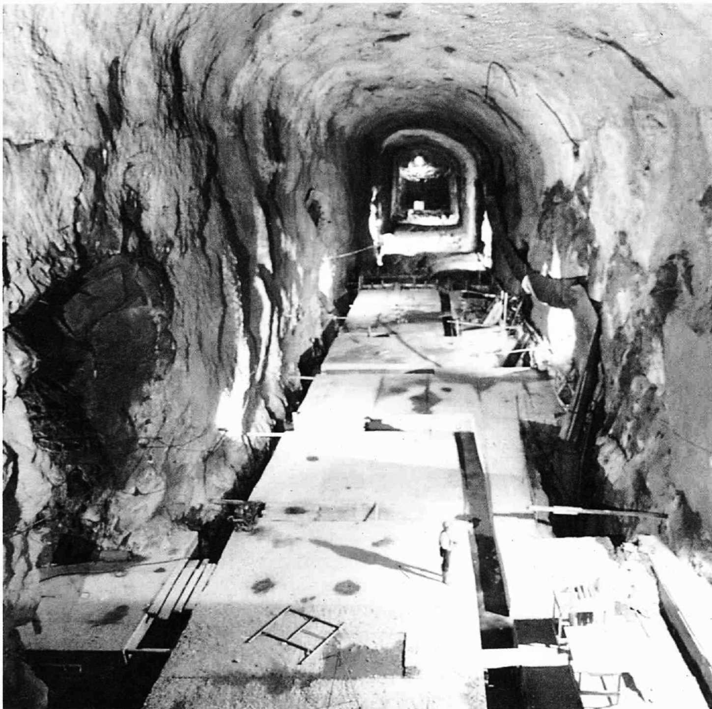
Galería de transformadores de la hidroeléctrica de San Carlos; página de enfrente, movimiento de tierras en Jaguas.
